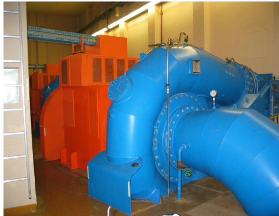
Generatoranlage 1700 kVA, 10 polig
