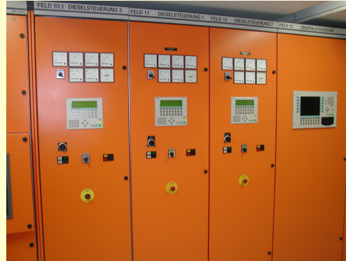
Neue Steuerung für 3 Anlagen
