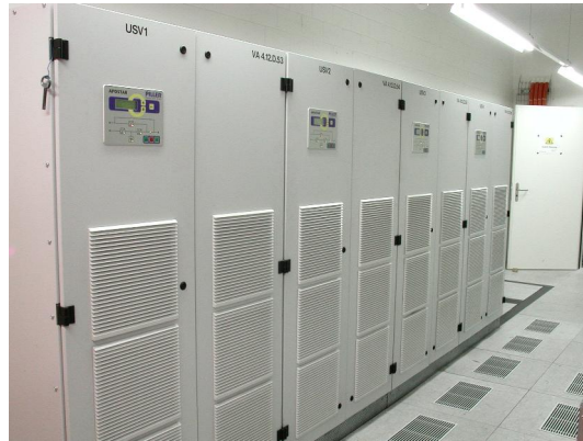
Neue USV-Anlage Piller Apostar AS IV 4 x 200 kVA auf 6 x 200 kVA ausbaubar
