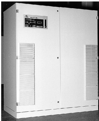
Bestehende statische USV Anlage
